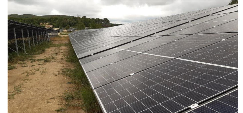
Les structures photovoltaïques s'adaptent à la topographie (source : IDE Environnement)
